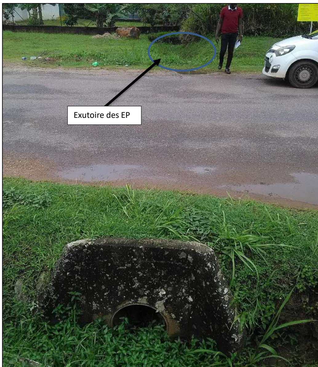
Figure 18 : Photographie de l'exutoire des EP
